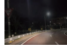
강남순환로 사당 IC 연성 방호 울타리 (낮게 깔리는 차량의 빔이 갈매기 표지에 도달하지 않아 야간 시인성이 미흡한 문제 보완)
